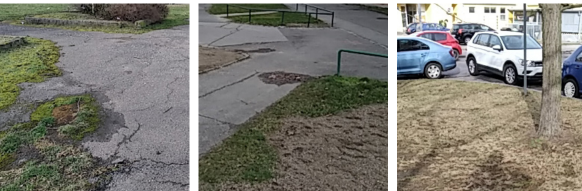
◀ Ukázka stavu povrchů a prostorových bariér (od vysokých obrubníků po parkující auta)
