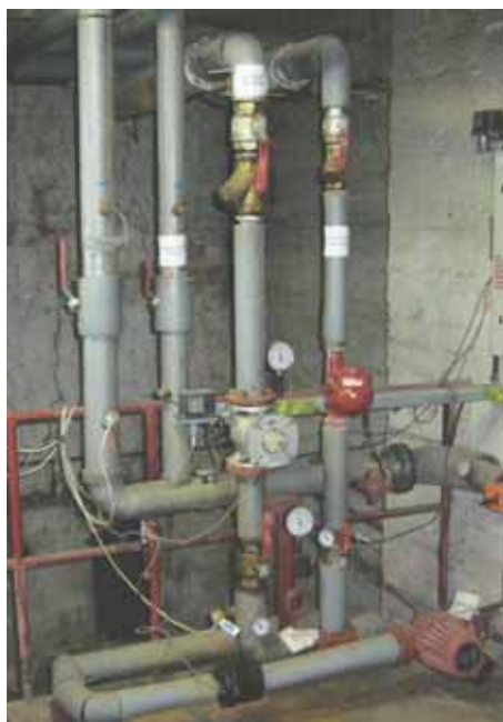
■ Společnost 4-Energetická vrátí MČ Praha 4 tepelná zařízení. Ilustrační foto: 4-Energetická
